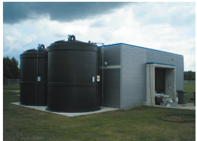
Abb. 4: Flotationsgebäude mit Chemikalienlagertanks
