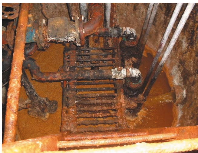
Abb. 1: Abwasserpumpwerk eines Lebensmittelbetriebs
