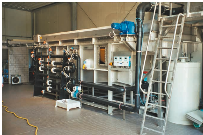
Abb. 6: Flotationsbecken mit Röhrenflockulator
