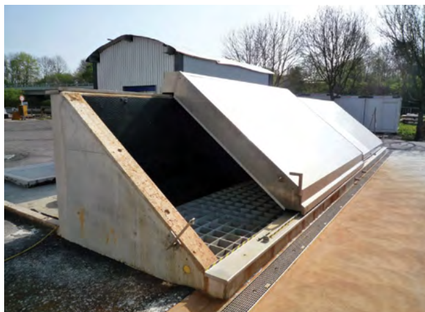
Abb. 1: Einschütte der Lösestation auf der Kläranlage Karlsruhe
