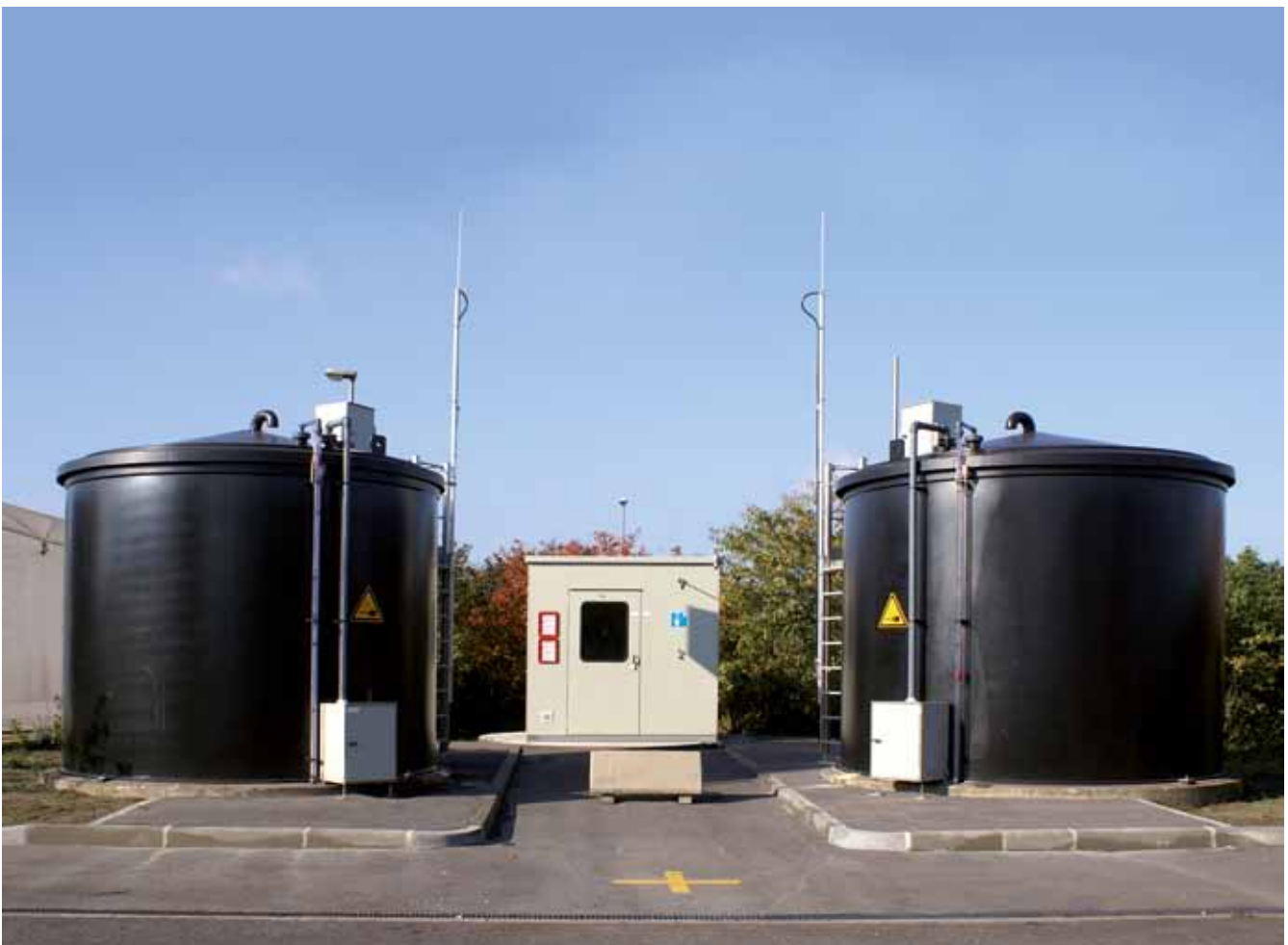
Abb. 3: Tank- und Dosieranlage
