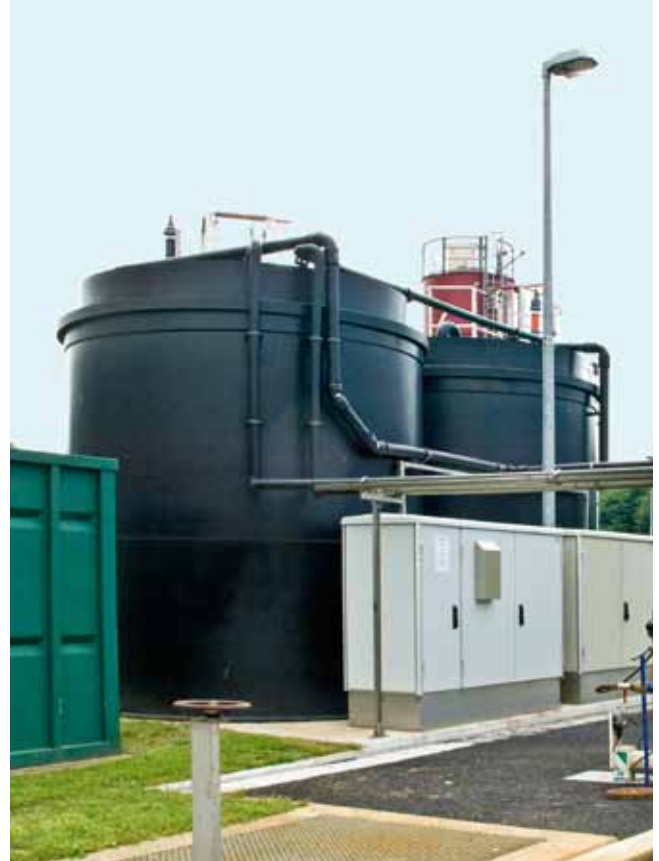
Abb. 5: Lager- und Dosierstation für flüssige Eisensalze
