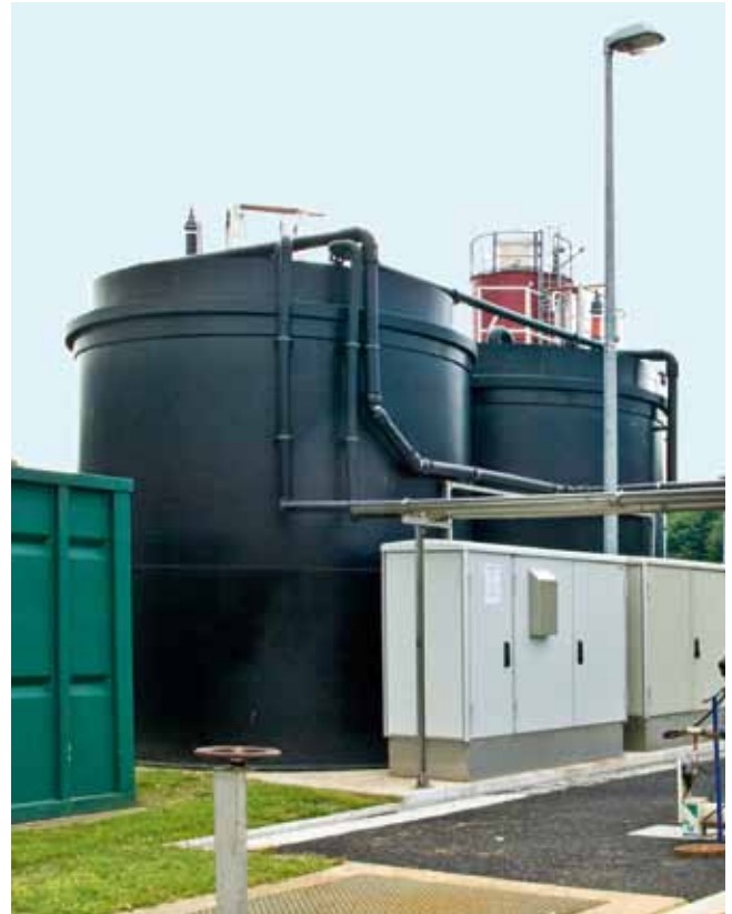
Figure 5 : Station de stockage et de dosage pour sels de fer liquides
