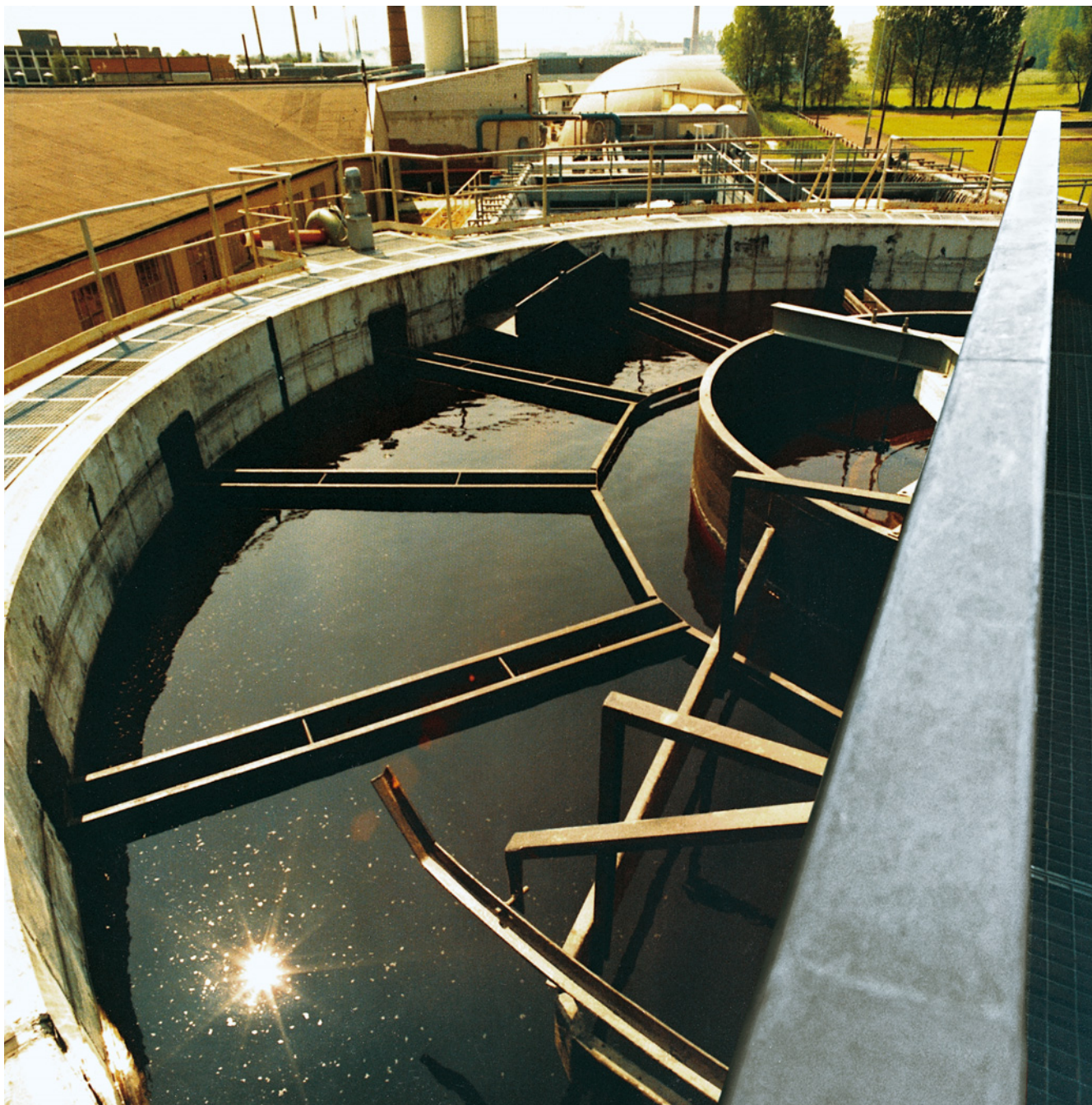
Fig. 3: Installation de précipitation
