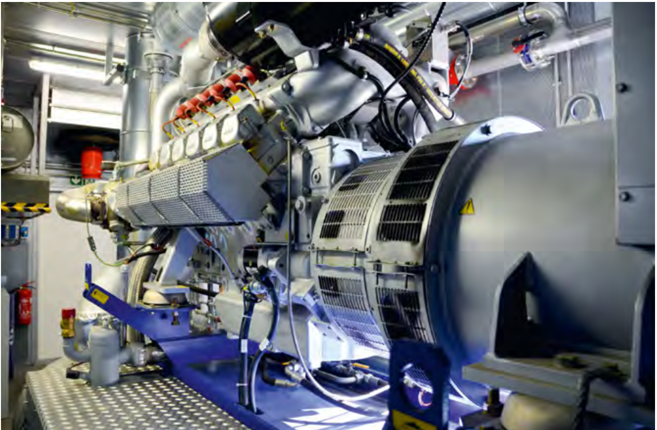
Abb. 5: Blockheizkraftwerk Kläranlage Wuppertal-Kohlfurth
