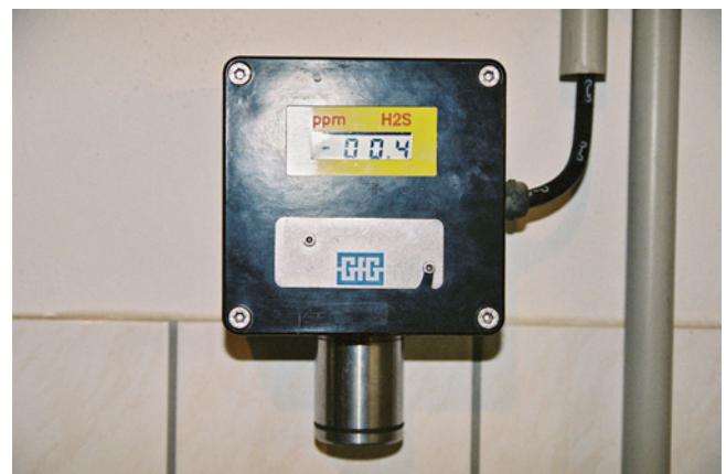
Abb. 8: Kontinuierliche Messwerterfassung mittels eines H 2 S-Sensors im Sandfanggebäude. Verarbeitung des Messsignals und Ansteuerung der KRONOFLOC Dosierpumpen. Die Ergebnisse sind in der Abb. 10 grafisch dargestellt.
