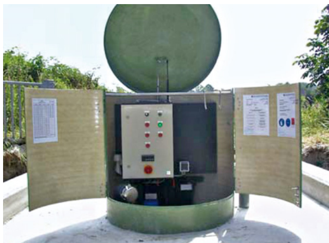
Abb. 3: Dosieranlage im Domschacht
