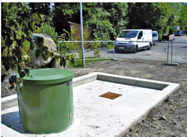
Abb. 2: Unterirdischer Tank am Pumpwerk mit WHG-konformer Auffangwanne
