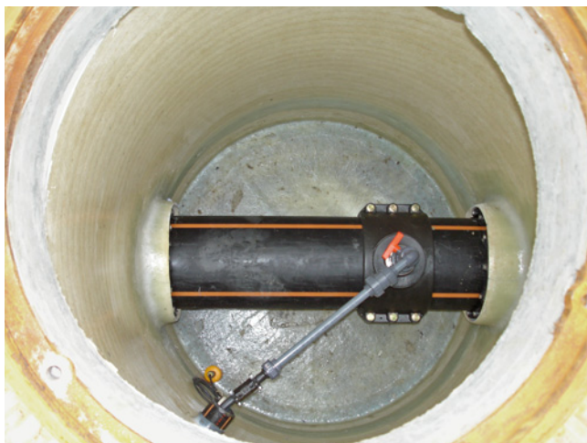
Abb. 5: Dosierung über Anbohrschelle direkt auf die Druckleitung
