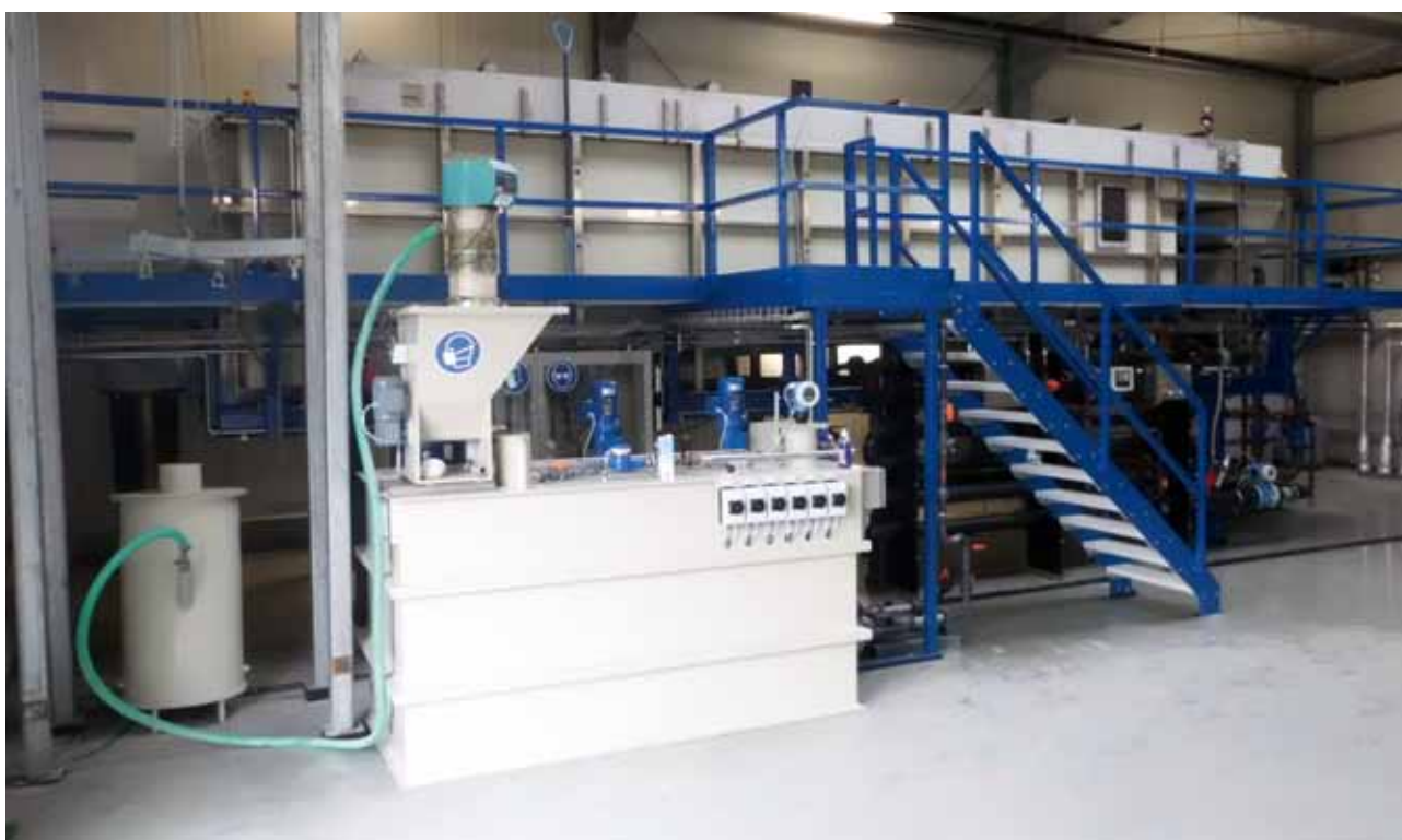
Abb. 1: Chemisch gestützte Flotationsanlage in Kunststoffbauweise als Vorbehandlung für Abwasser
