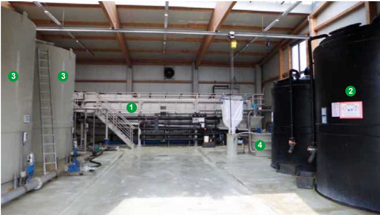
Abb. 9: 1 Flotationsanlage mit vorgeschaltetem Rohrreaktor 2 Fällmitteltank (25m 3 ) 3 Flotatschlammbehälter 4 Polymerstation
