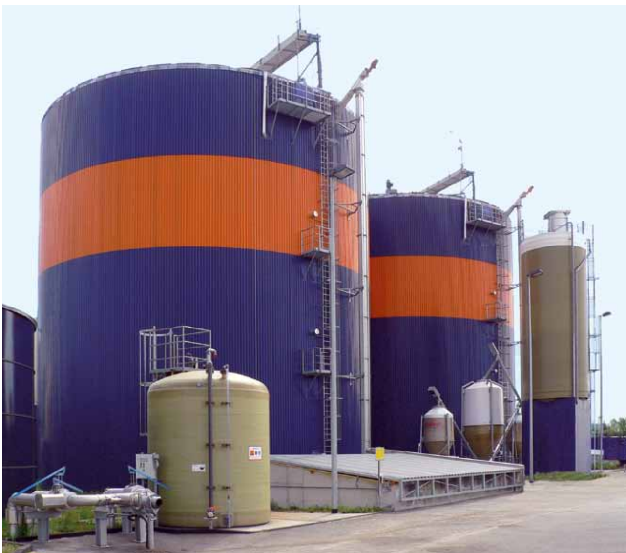
Fig. 1 : installation de gaz vert Rathenow, Brandebourg [3]
